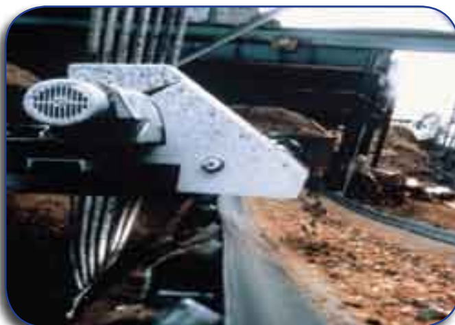
Banda transportadora para introducir madera y CDL al sistema de caldera Foto cortesía de Terry Gray, TAG
