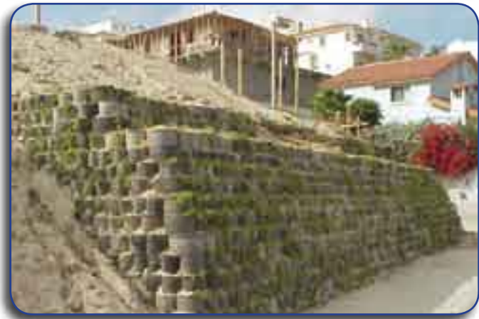
Muro de llantas enteras para evitar la erosión del suelo. Foto cortesía de la Comisión Estatal de Servicios Públicos de Tecate
